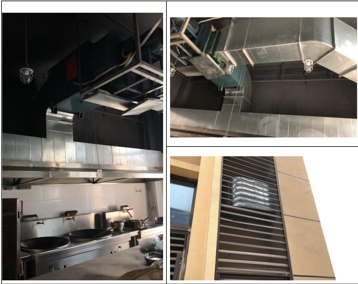
图 4-3 食堂油烟收集及处理装置照片
